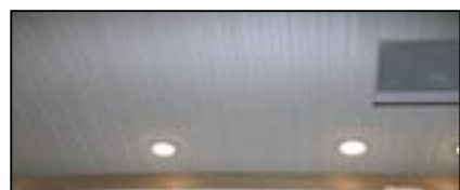
Slika 6: velik toplotni most predstavlja konstrukcija stropa - strehe.
