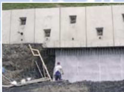
Slika 3: raba drenažnih geokompozitov pri gradnji sidranih opornih konstrukcij na AC Trojane – Blagovica po sistemu od zgoraj navzdol. V tako zahtevnih konstrukcijah bi bila raba klasičnih drenažnih zasipov izjemno zamudna in zapletena.
