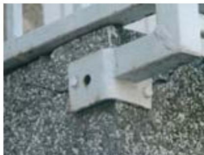
Robna razdalja pritrčila in osna razdalja nista zadostni. Zaradi obremenitev na robu balkonske plošče se le-ta zlomi.
