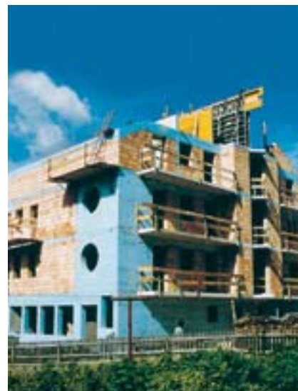
Slika 3: Tipičen primer izolacije toplotnih mostov, ki hkrati prekriva velik del zidu (Fotografija: Dow Building Solutions)
