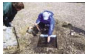
Slika 14: Strokovnjak ocenjuje tudi stanje tesnjenja strehe pod ploščo ROOFMATE.
