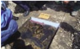
Slika 6: Po odvzemu plošče ROOFMATE je bilo tesnjenje strehe jasno vidno.
