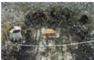
Slika 8: Na drugem mestu odvzema je bil odstranjen sloj proda – vidna je zgornja stran plošče ROOFMATE.
